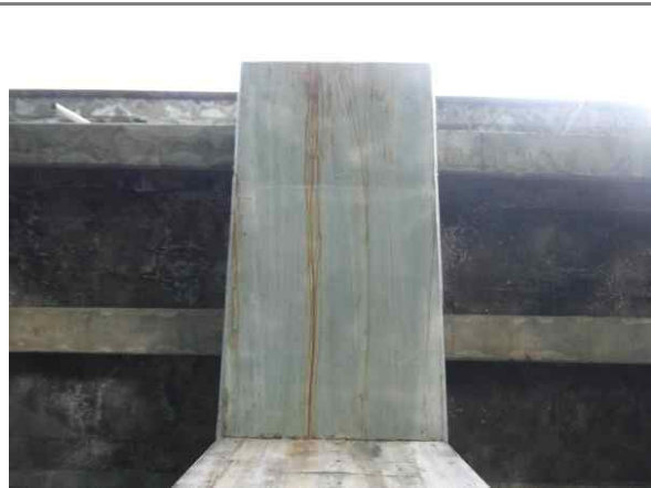
도면번호 : 84 교각 P9 손상현황 : 09 백태
