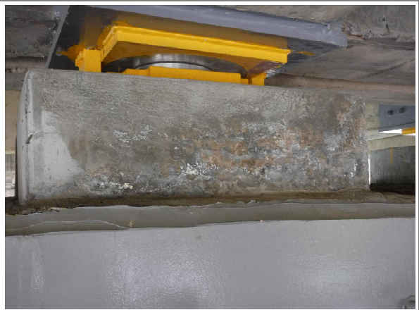
도면번호 : 84 교각 P9 손상현황 : 08 백태
