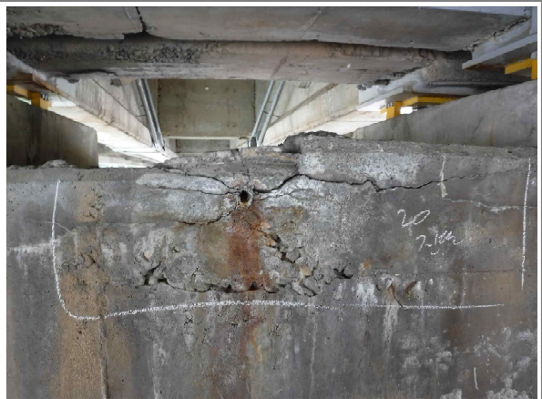
도면번호 : 81 교각 P6 손상현황 : 04 파손
