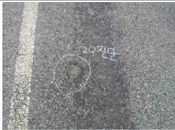
도면번호 : 03 바닥판 상면 S3 교면포장 손상현황 : 18 포트홀
