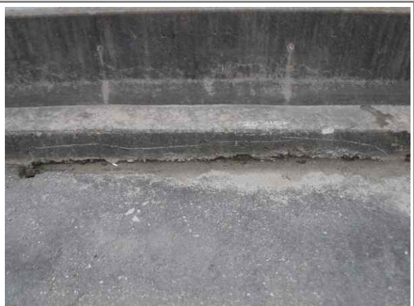
도면번호 : 10 바닥판 상면 S10난간 손상현황 : 03 연석 침식
