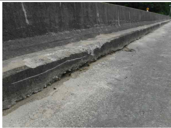
도면번호 : 03 바닥판 상면 S3 난간 손상현황 : 04 연석 침식
