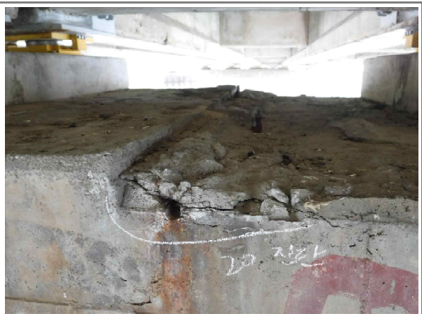
도면번호 : 81 교각 P6 손상현황 : 08 박리
