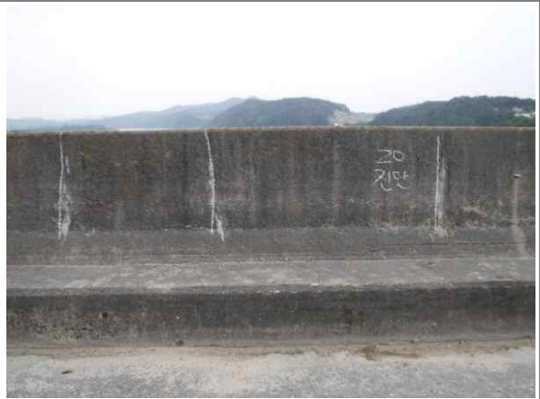
도면번호 : 07 바닥판 상면 S7 난간 손상현황 : 02 균열부백태
