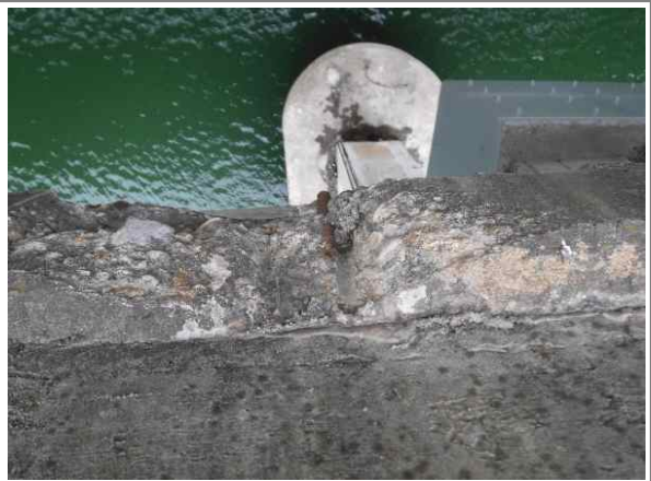
도면번호 : 09 바닥판 상면 S9 난간 손상현황 : 11 방호벽 파손
