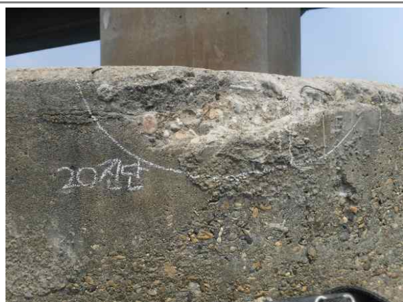
도면번호 : 85 교각 P10 기초부 손상현황 : 03 파손
