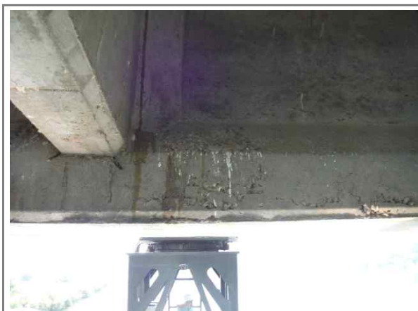
도면번호 : 49 PSCI 거더 S12 G5 손상현황 : 02 재료분리
