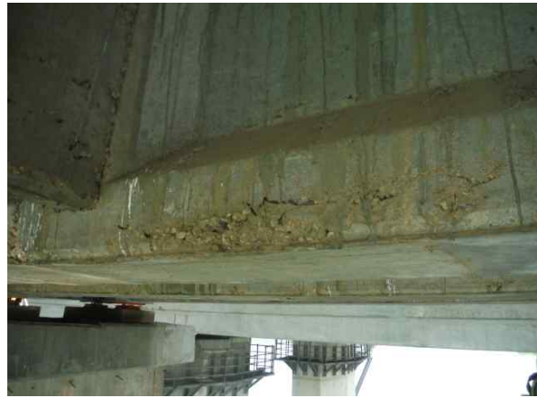
도면번호 : 48 PSCI 거더 S11 G3 손상현황 : 09 재료분리
