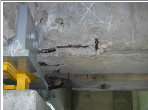
도면번호 : 68 바닥판 가로보 S13 손상현황 : 06 박락/철근노출
