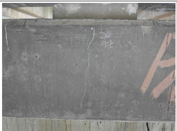
도면번호 : 85 교각 P10 손상현황 : 01 균열
