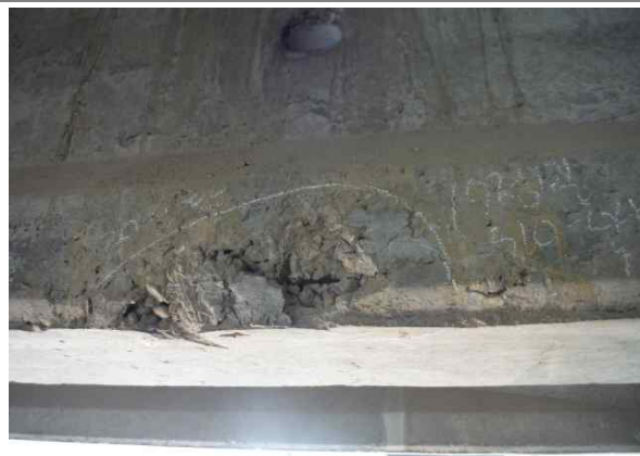
도면번호 : 47 PSCI 거더 S10 G4 손상현황 : 10 재료분리/철근노출
