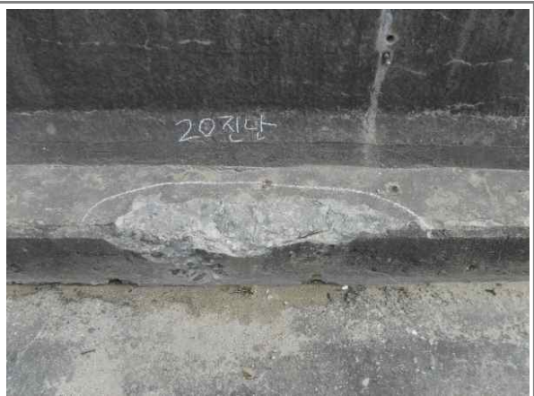
도면번호 : 03 바닥판 상면 S3 난간 손상현황 : 01 연석 파손
