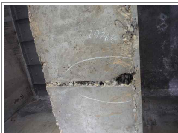
도면번호 : 50 PSCI 거더 S13 G2 손상현황 : 06 철근노출
