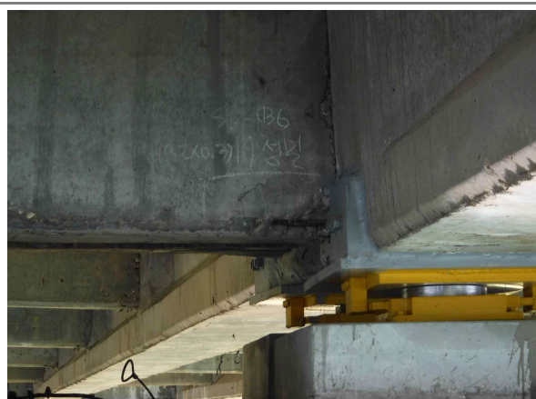
도면번호 : 67 바닥판 가로보 S12 손상현황 : 03 박락/철근노출
