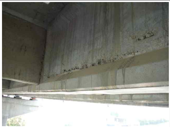
도면번호 : 48 PSCI 거더 S11 G3 손상현황 : 08 재료분리
