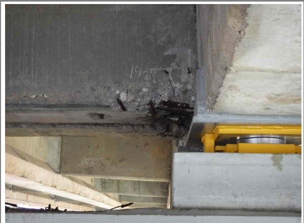
도면번호 : 67 바닥판 가로보 S12 손상현황 : 02 박락/철근노출
