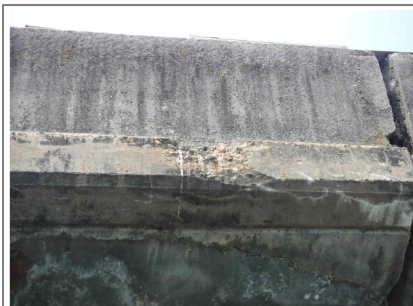
도면번호 : 22 바닥판 하면 S3 손상현황 : 03 파손
