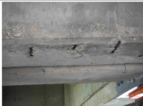
도면번호 : 65 바닥판 가로보 S10 손상현황 : 01 철근노출
