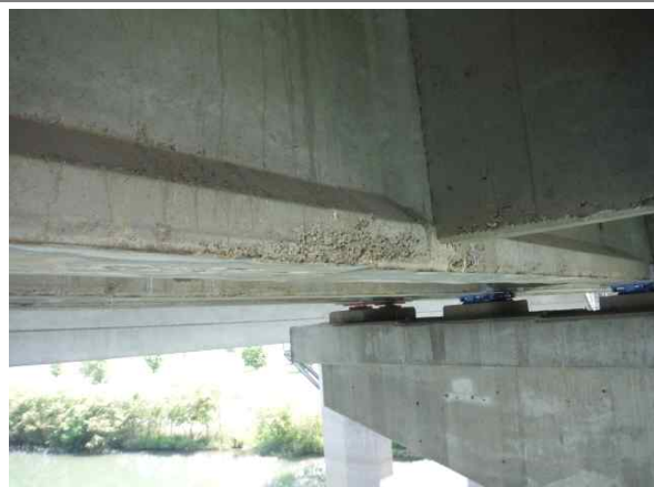
도면번호 : 48 PSCI 거더 S11 G3 손상현황 : 12 재료분리
