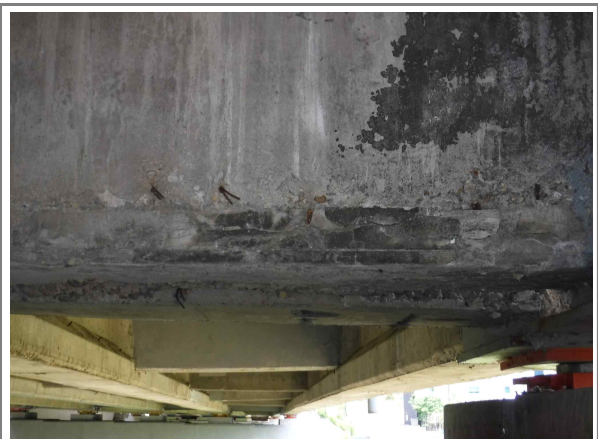
도면번호 : 70 바닥판 가로보 S15 손상현황 : 14 박리/철근노출
