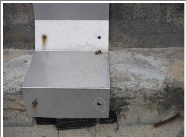
도면번호 : 06 바닥판 상면 S6 난간 손상현황 : 04 방호벽 신축이음 덮개 탈락
