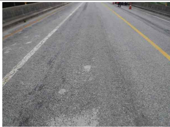
도면번호 : 06 바닥판 상면 S6 교면포장 손상현황 : 10 아스콘 망상균열
