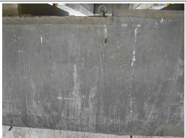
도면번호 : 85 교각 P10 손상현황 : 04 균열
