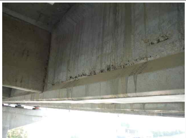
도면번호 : 48 PSCI 거더 S11 G1 손상현황 : 15 재료분리
