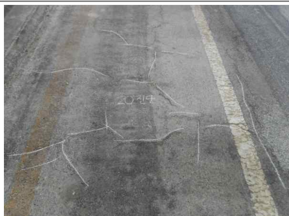
도면번호 : 02 바닥판 상면 S2 교면포장 손상현황 : 07 아스콘 망상균열
