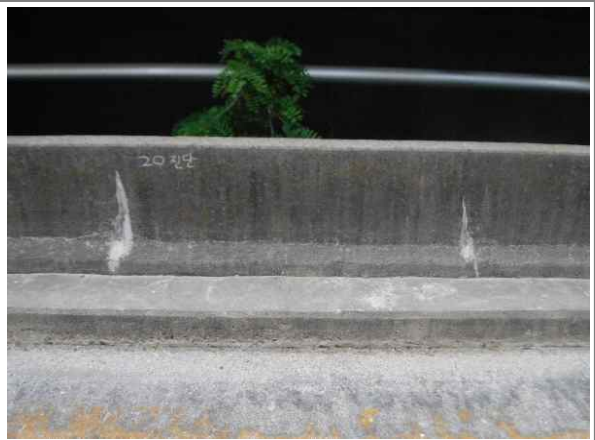
도면번호 : 01 바닥판 상면 S1 난간 손상현황 : 07 균열부백태
