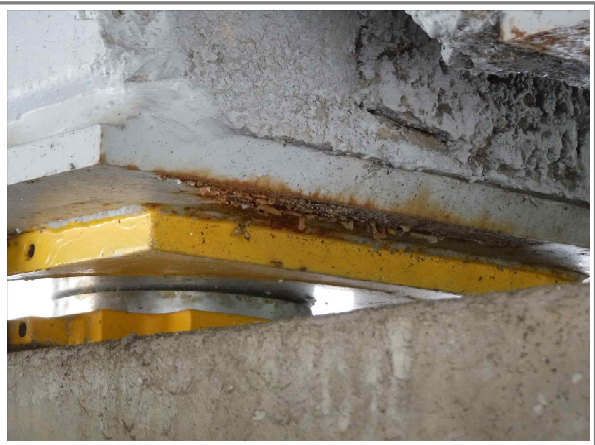
도면번호 : 81 교각 P6 손상현황 : 06 받침장치 부식
