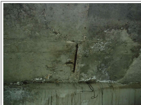
도면번호 : 25 바닥판 하면 S6 손상현황 : 04 박락/철근노출
