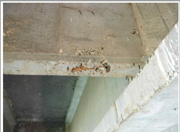
도면번호 : 68 바닥판 가로보 S13 손상현황 : 08 재료분리/철근노출
