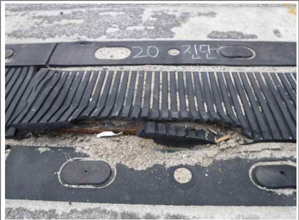
도면번호 : 03 바닥판 상면 S3 신축이음부 손상현황 : 16 고무제 파손/강판 부식
