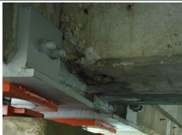
도면번호 : 66 바닥판 가로보 S11 손상현황 : 03 재료분리/철근노출
