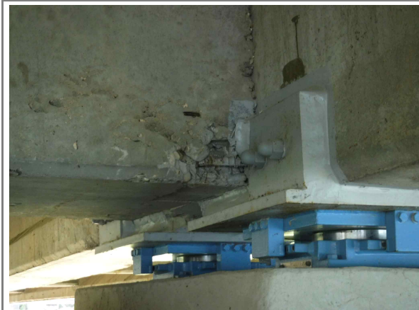
도면번호 : 69 바닥판 가로보 S14 손상현황 : 06 재료분리/철근노출
