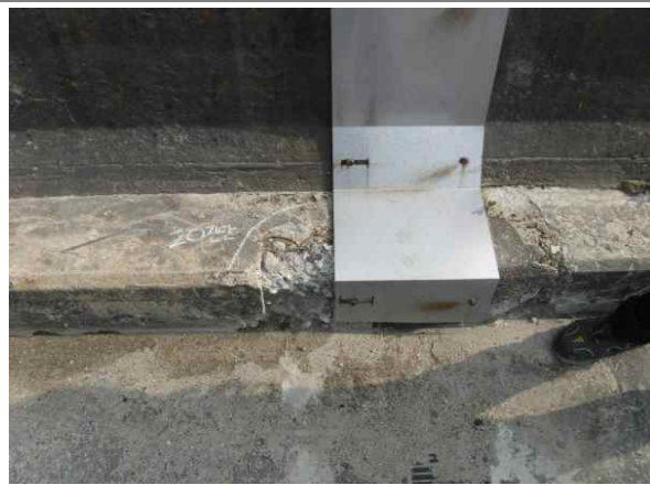
도면번호 : 01 바닥판 상면 S1 난간 손상현황 : 01 연석 파손
