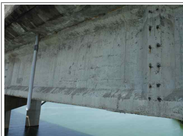
도면번호 : 49 PSCI 거더 S12 G5 손상현황 : 05 철근노출
