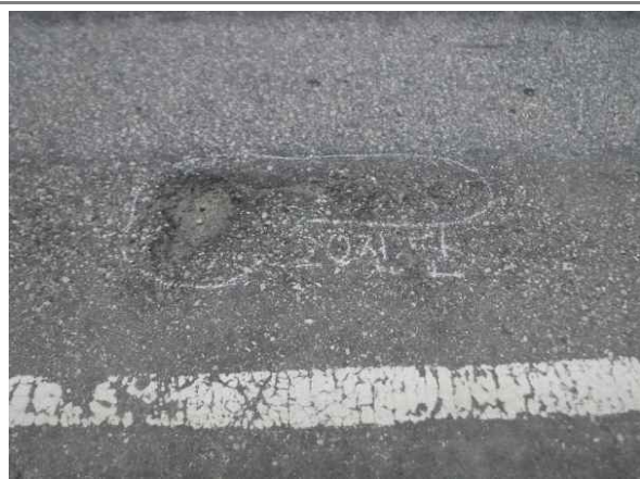
도면번호 : 05 바닥판 상면 S5 교면포장 손상현황 : 05 아스콘 패임
