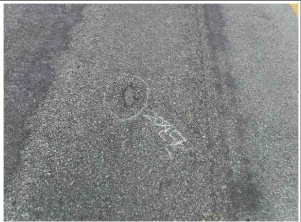
도면번호 : 02 바닥판 상면 S2 교면포장 손상현황 : 02 포트홀
