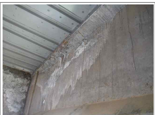
도면번호 : 51 PSCI 거더 S14 G5 손상현황 : 01 백태
