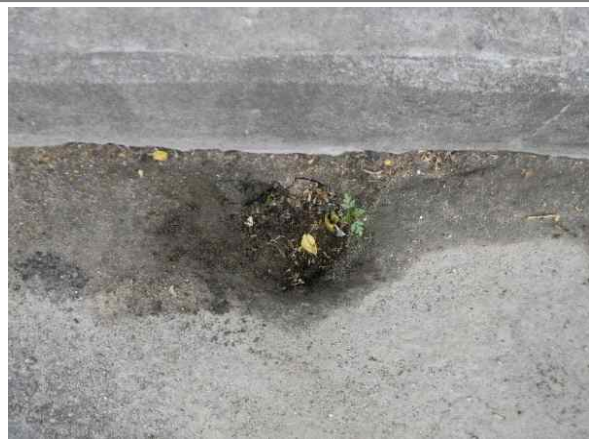
도면번호 : 01 바닥판 상면 S1 손상현황 : 16 배수구 막힘
