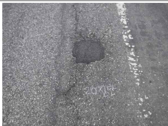
도면번호 : 09 바닥판 상면 S9 교면포장 손상현황 : 19 아스콘 균열
