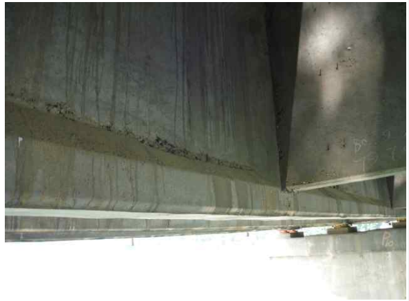
도면번호 : 48 PSCI 거더 S11 G3 손상현황 : 11 재료분리
