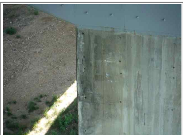
도면번호 : 49 PSCI 거더 S12 G3 손상현황 : 04 철근노출
