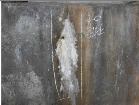
도면번호 : 81 교각 P6 손상현황 : 05 백태
