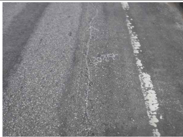
도면번호 : 07 바닥판 상면 S7 교면포장 손상현황 : 04 아스콘 균열
