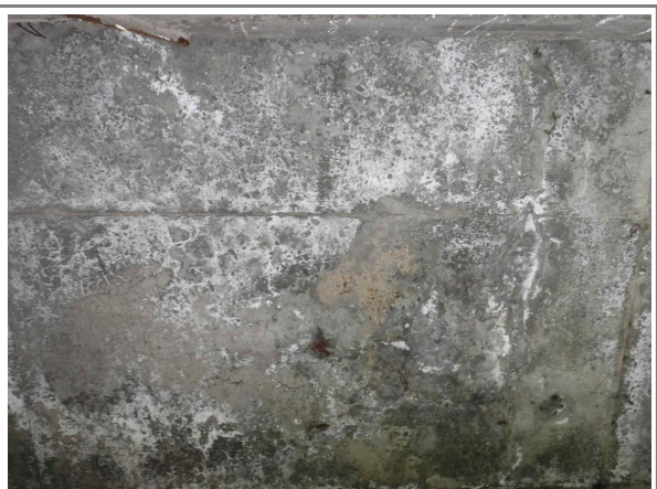
도면번호 : 25 바닥판 하면 S6 손상현황 : 05 망상균열/백태
