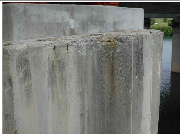
도면번호 : 81 교각 P6 손상현황 : 03 팡상균열/백태
