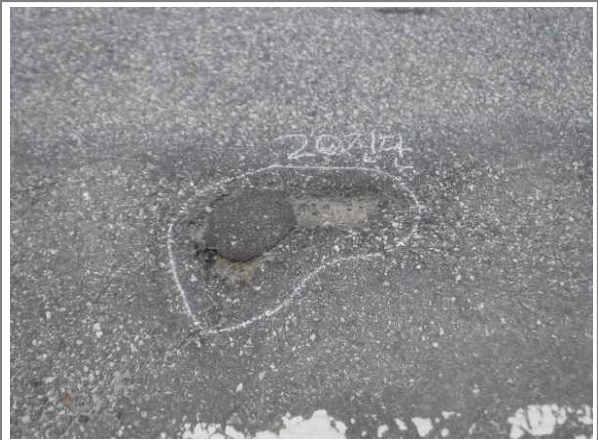
도면번호 : 04 바닥판 상면 S4 교면포장 손상현황 : 09 아스콘패임
