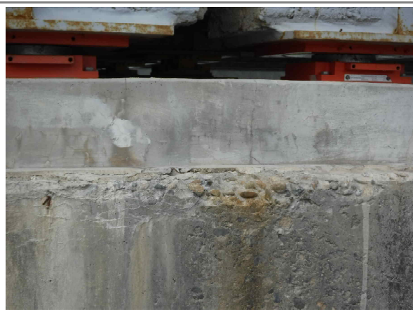
도면번호 : 81 교각 P6 손상현황 : 07 파손
